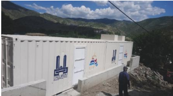
Oltu İçmesuyu Paket Arıtma Sistemi
