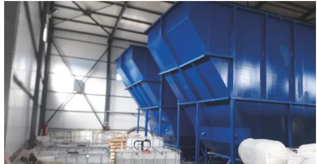
Horasan Arıtma Tesisi Lamelli Sistemi
